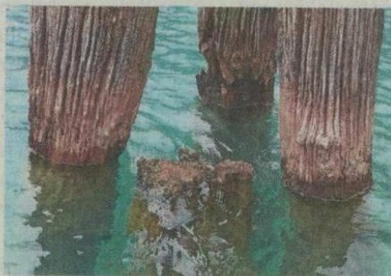
Sichtbar morsch: Die Pfähle im Föhnhafen müssen dringend ersetzt werden.
