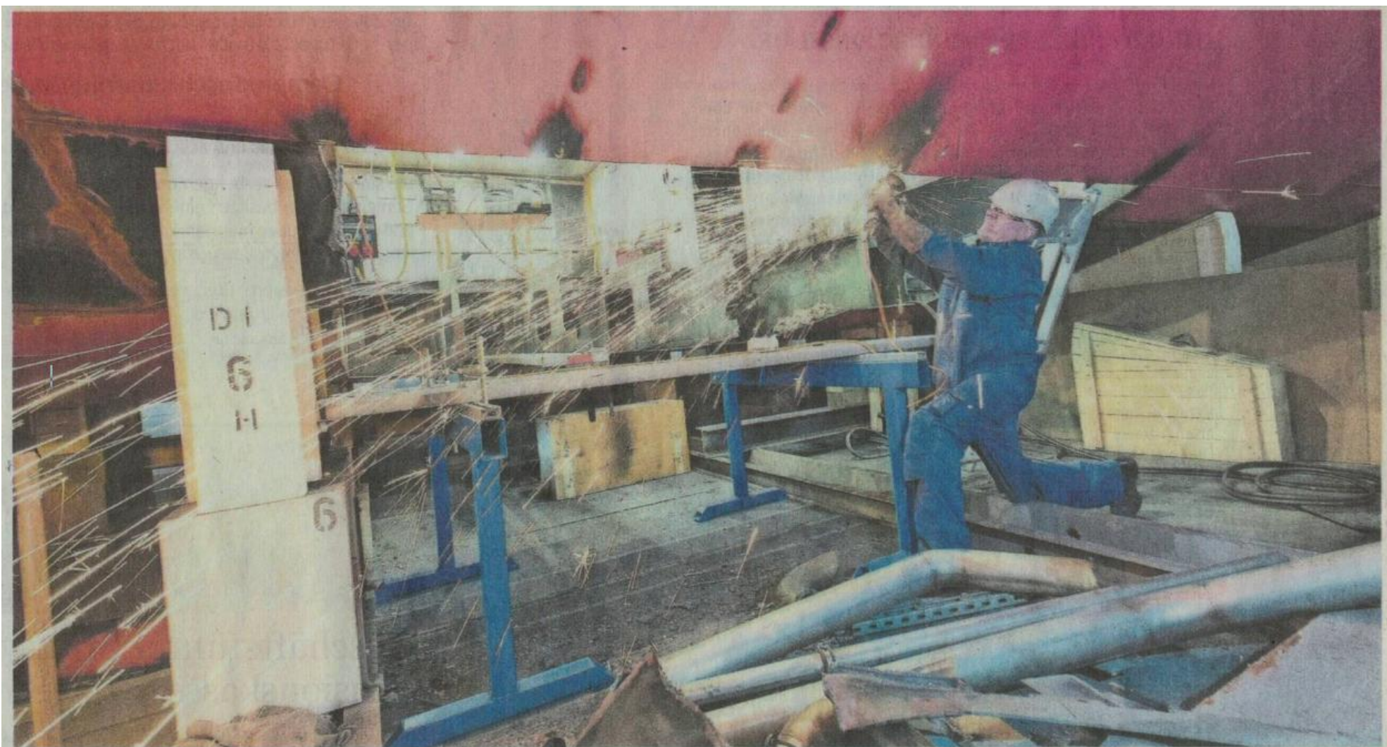
Ein Angestellter der Shiptec AG in der Luzerner Werft bei Schweissarbeiten am Rumpf des MS Diamant.
