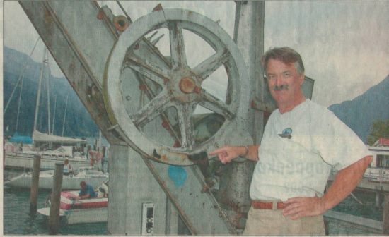
Urs Koller, Präsident der IGF «Nüsi Schiffig» in Brunnen, zeigt auf eine vom Rost komplett zerrissene Stelle am altersschwachen Kran beim Föhnhafen. Er freut sich auf den Neuen.
