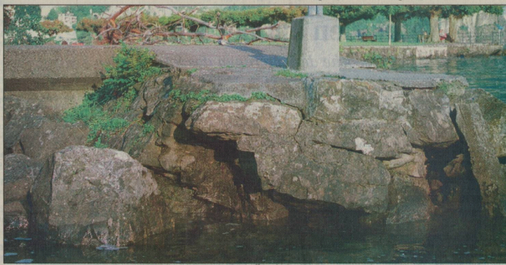
Desolater Zustand der südlichen Mole im Föhnhafen Brunnen: Heftige Stürme und der ständige Wellenschlag haben die Fundamente unterspült, der Bruchsteindamm bricht regelrecht auseinander.
