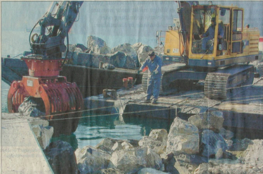
An der Molenspitze des Föhnhafens wird tüchtig gebaggert. Die alte Mole drohte im See zu versinken. Wellenbrecher werden platziert. BILD: SAMUEL NIDERÖST
